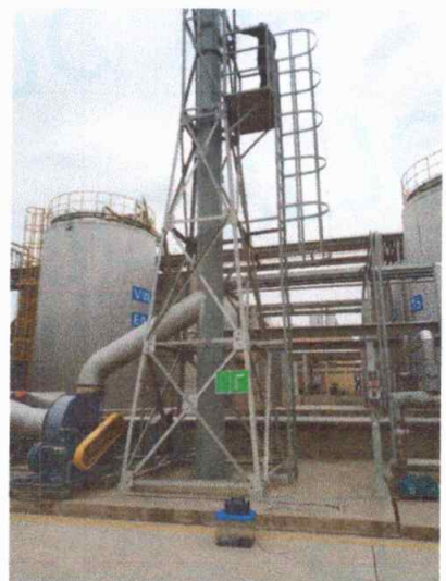
罐区一排气筒出口 04#
